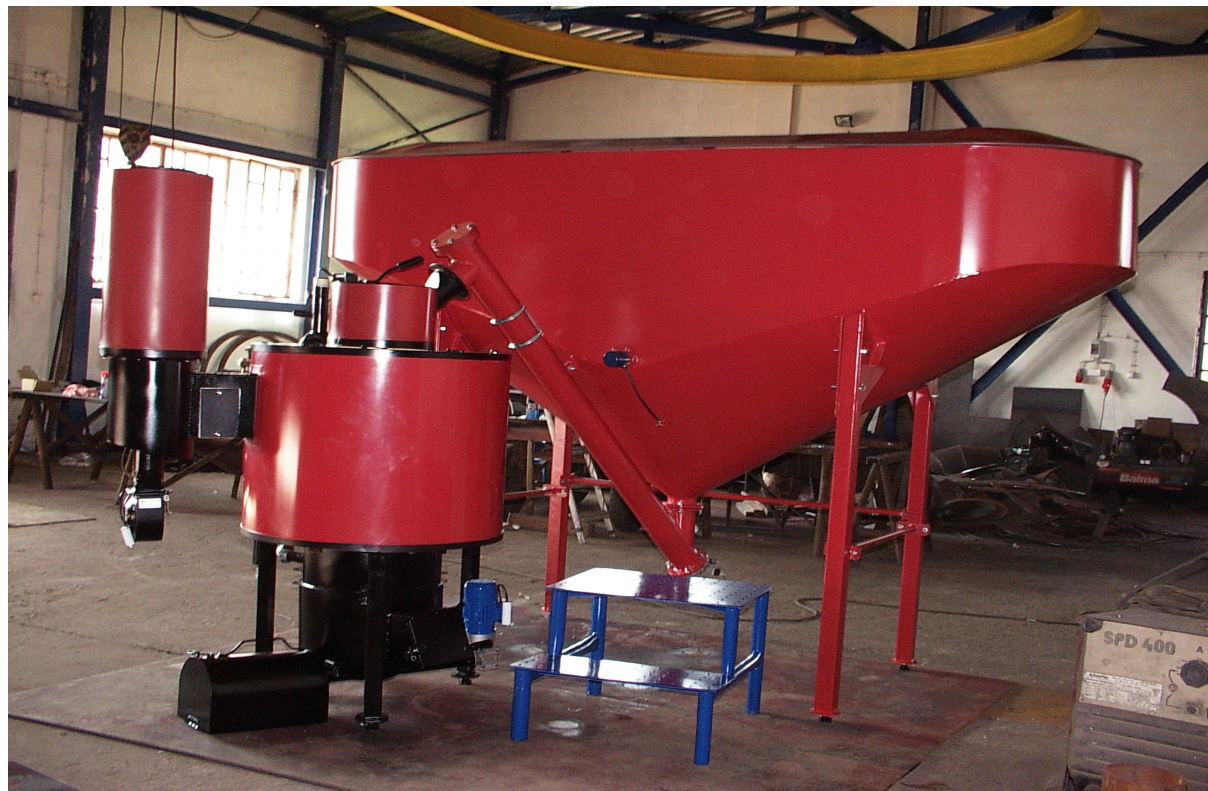
Foto 5. Układ kotłowni z pełną automatyką kotła. Zestaw składa się z kotła MŁ 45kW i zbiornik hybrydowy o pojemności 2000 litrów.
