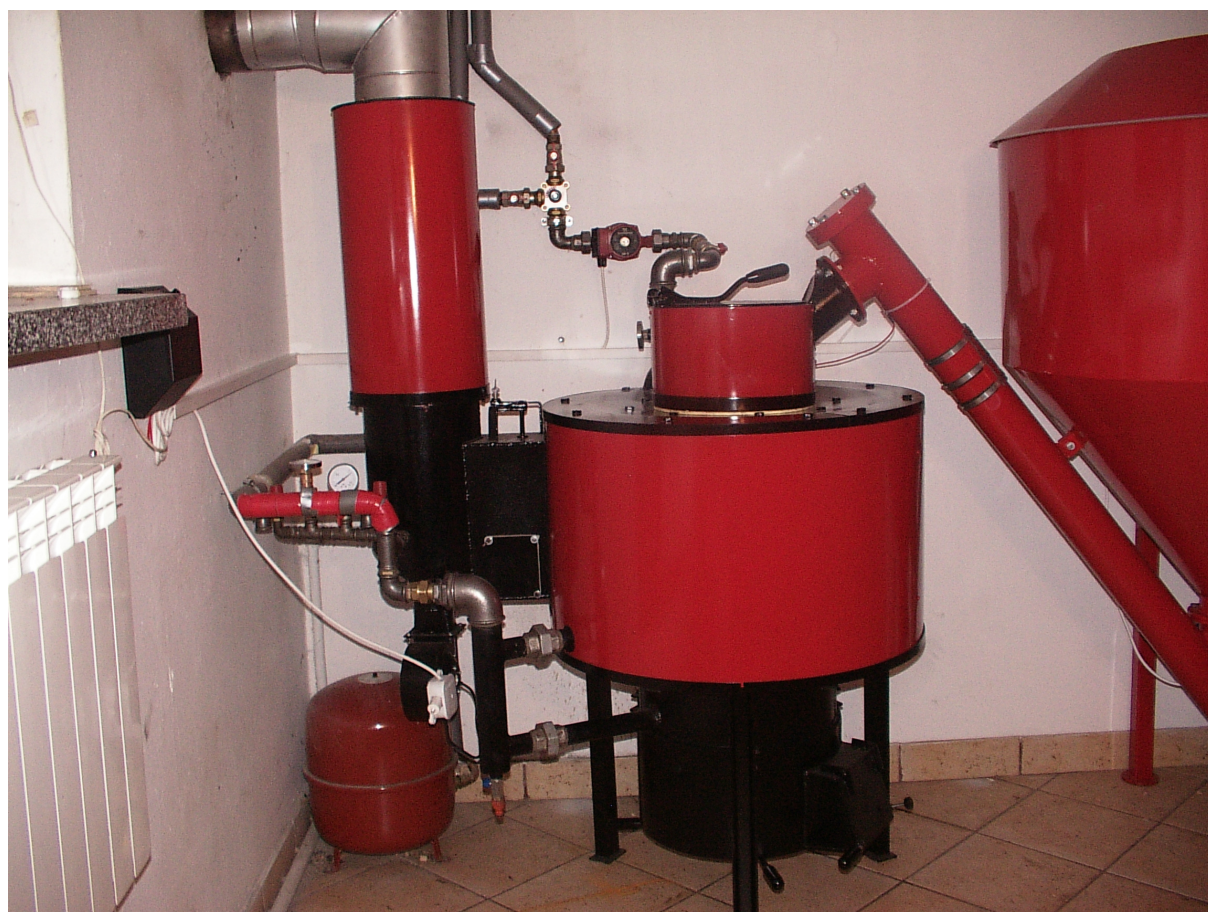
Foto 2. Kocioł firmy „MARSZ” typu MŁ-30kW
