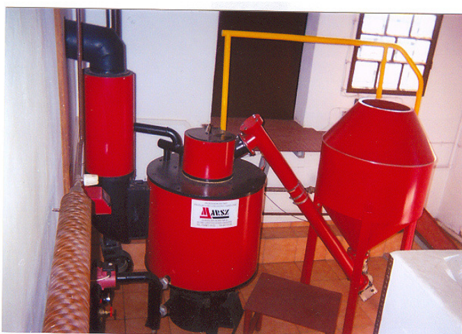
Foto3. Układ kotłowni kocioł MŁ-45kW i zbiornik przykotłowy o pojemności 300 litrów.
