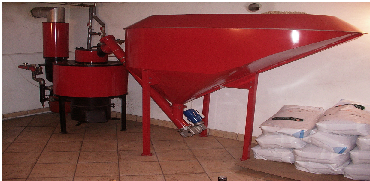
Foto 4. Układ kotłowni w zestawie kocioł MŁ 30kW i zbiornik hybrydowy o pojemności 850 litrów.
