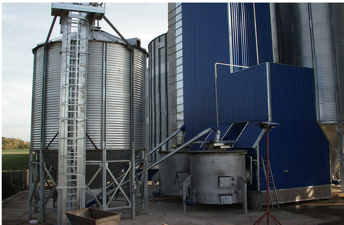
Foto 8. Zestawienie przedpaleniska z wymiennikiem ciepła; spaliny-powietrze.
